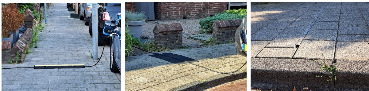
Toepassing van VPA in Haarlem met van links naar rechts kabelbrug, kabelmat en kabelgoot
